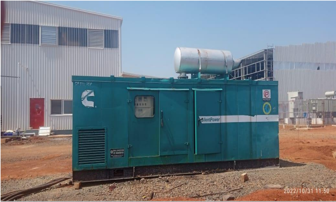
500KVA DG Set
