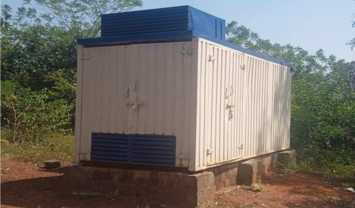
100KVA DG SET
